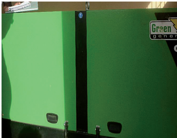
Nouveau générateur pour la radio acquis sur financement de la DDC
